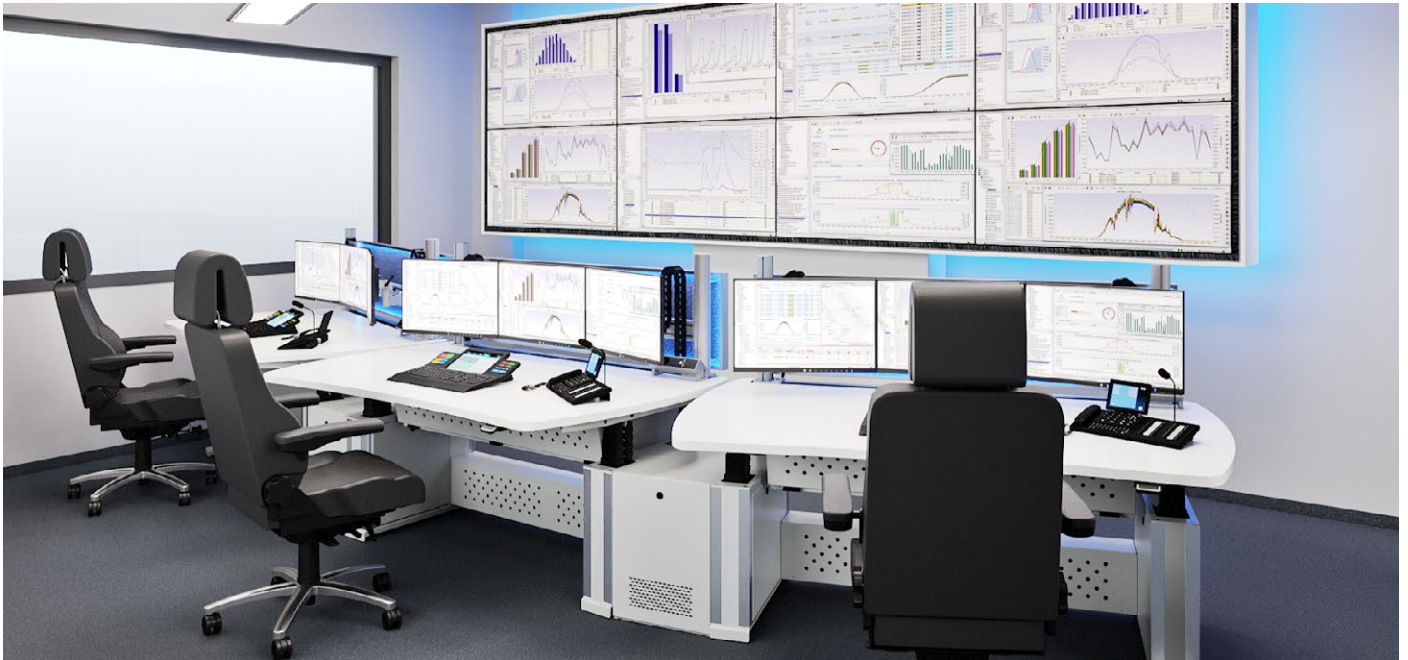
ControlDesk ONE.4 | Tische in parabolischer Anordnung mit elektrischer Monitor-Höhenverstellung (unabhängig von Tischhöhenverstellung)
