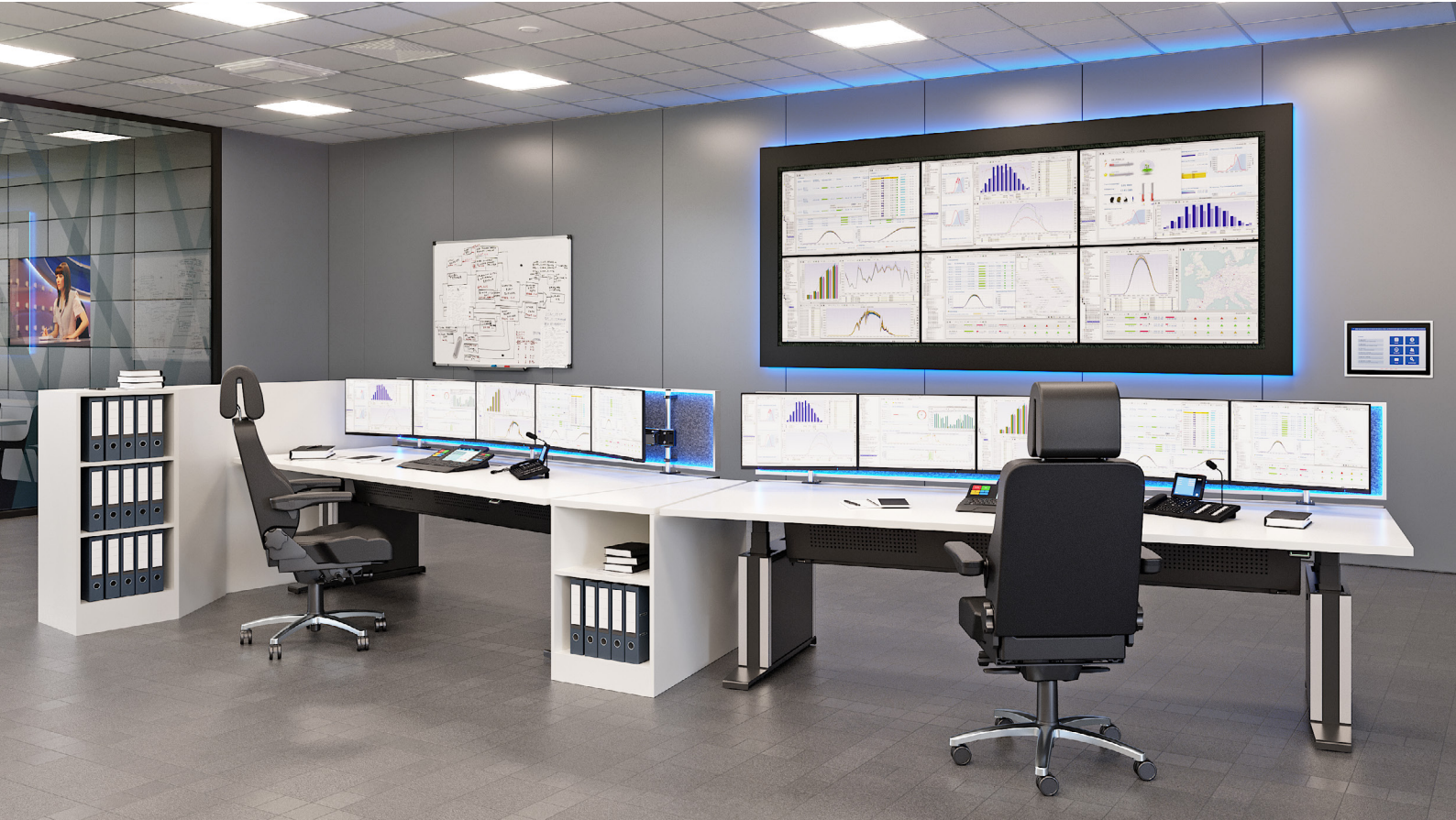
Leitstand mit ControlDesk ONE.4 Tischsystem und Großbildwand
